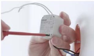
01 Koppel de DALI ACU BT aan de stroom- en DALI bedrading van de LED driver/E-VSA
